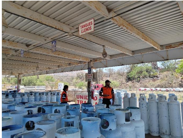
Imagen 3. Revisión en Estación de Carburación.
